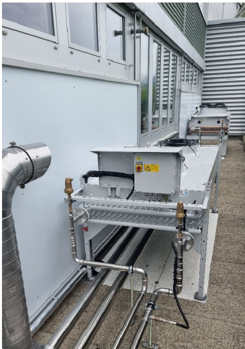
Energieoptimierte Platzierung der Rückkühler hinter dem Gebäude am Schatten
