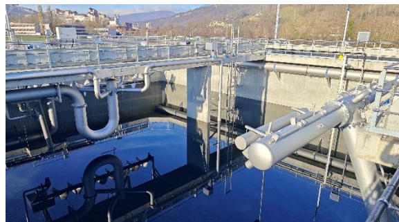
November 2023: Teilweise Füllung der Becken wegen des Auftriebes durch das Grundwasserniveau
