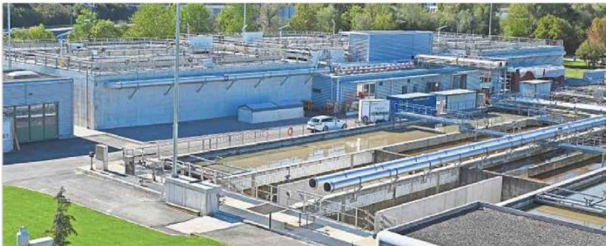
Die Rohrleitungen, welche das Abwasser in die SBR-Reaktoren befördern, sind momentan im Bau.
