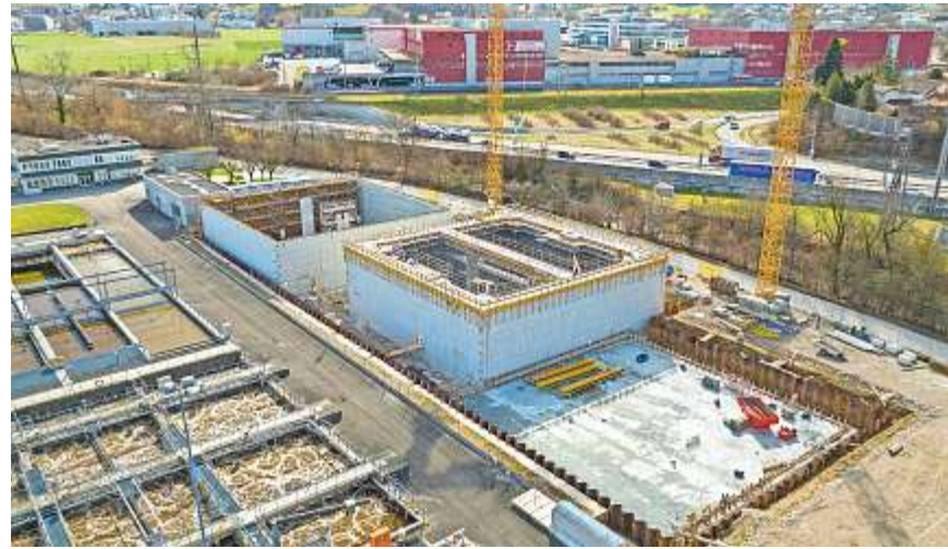
Blick auf die im Bau befindlichen neuen Biologiebecken, welche auf dem Reserveland der Kläranlage zu stehen kommen. BILD: ZVG
