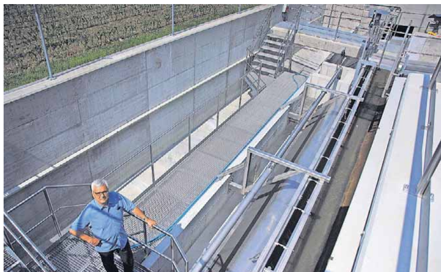
Mit dieser Anlage werden die Wigger und der Tych von grossen Mengen von überlaufendem sogenannten Mischabwasser bei starken Regenfällen entlastet.
