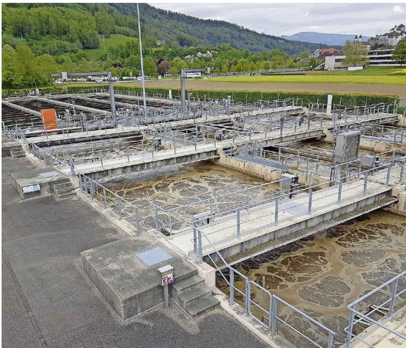
Die biologische Reinigungsstufe mit Belüftungs- und Nachklärbecken der ARA Aarburg hat die Kapazitätsgrenzen erreicht. ZVG
