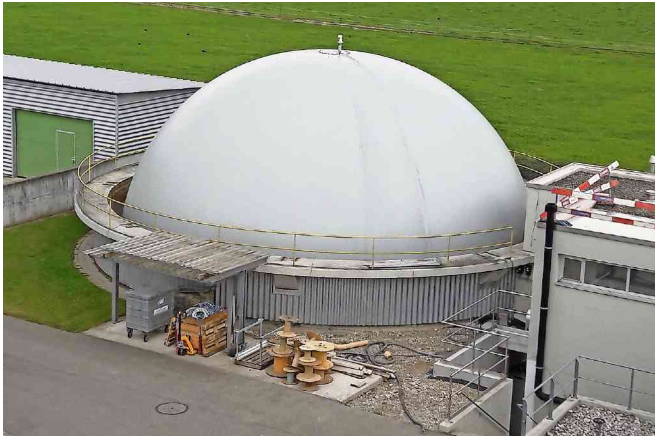
Der neue Gasspeicher mit einem Volumen von über 1000 Kubikmeter ist bereits in Betrieb.
