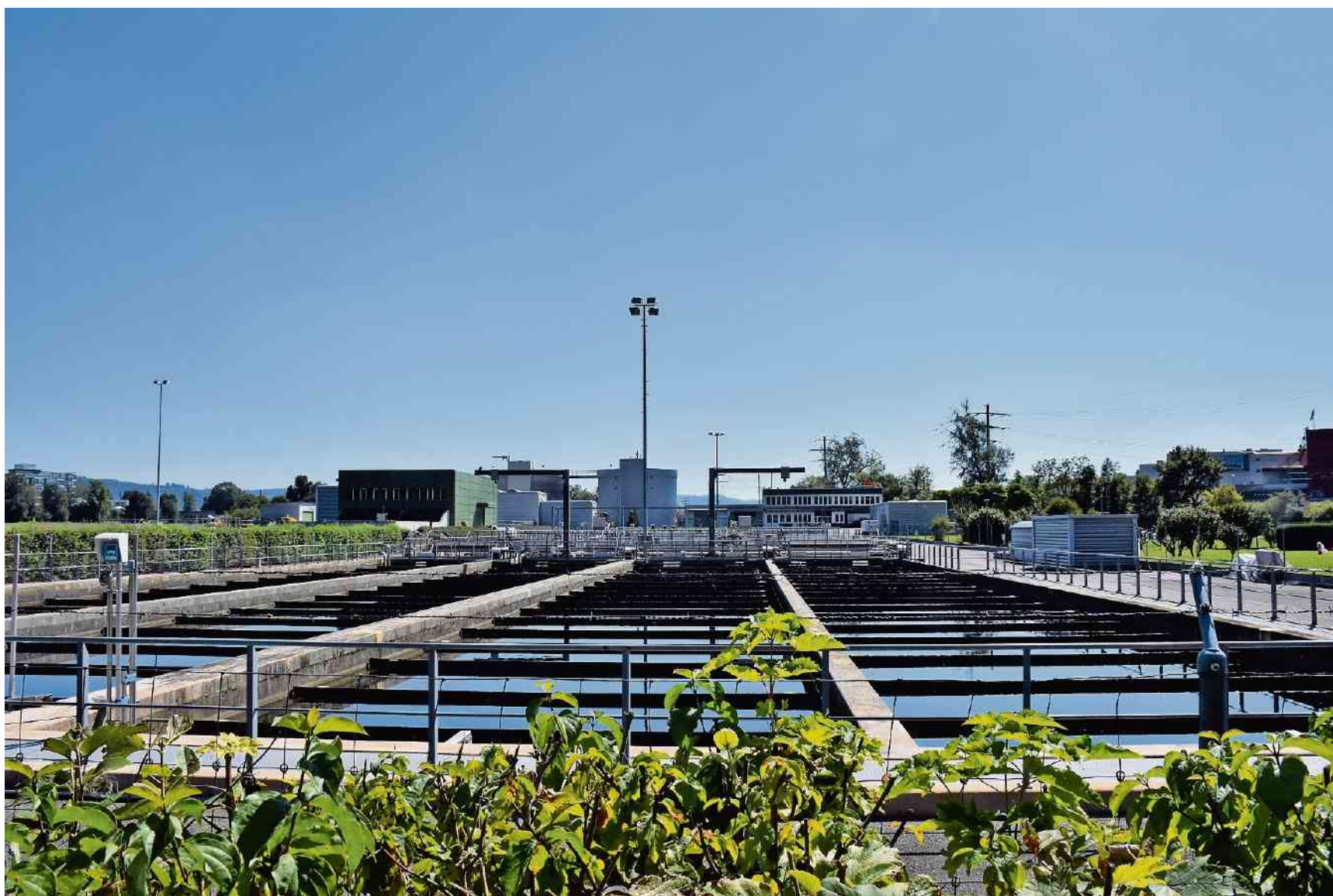
Die ARA Aarburg bedient sieben Verbandsgemeinden. Das Abwasser wird wie bisher mechanisch, biologisch und chemisch gereinigt.
